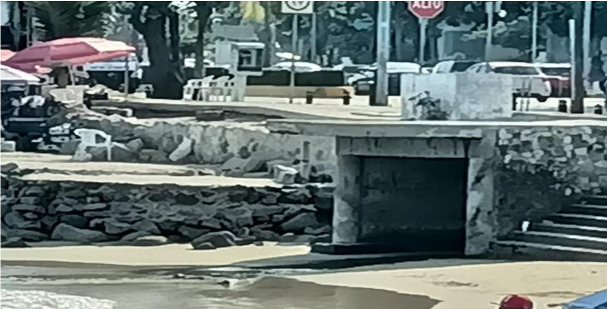
Imagen 5. Salida de aguas negras a la Playa Hornos de Acapulco. Fuente. propia, 2021
