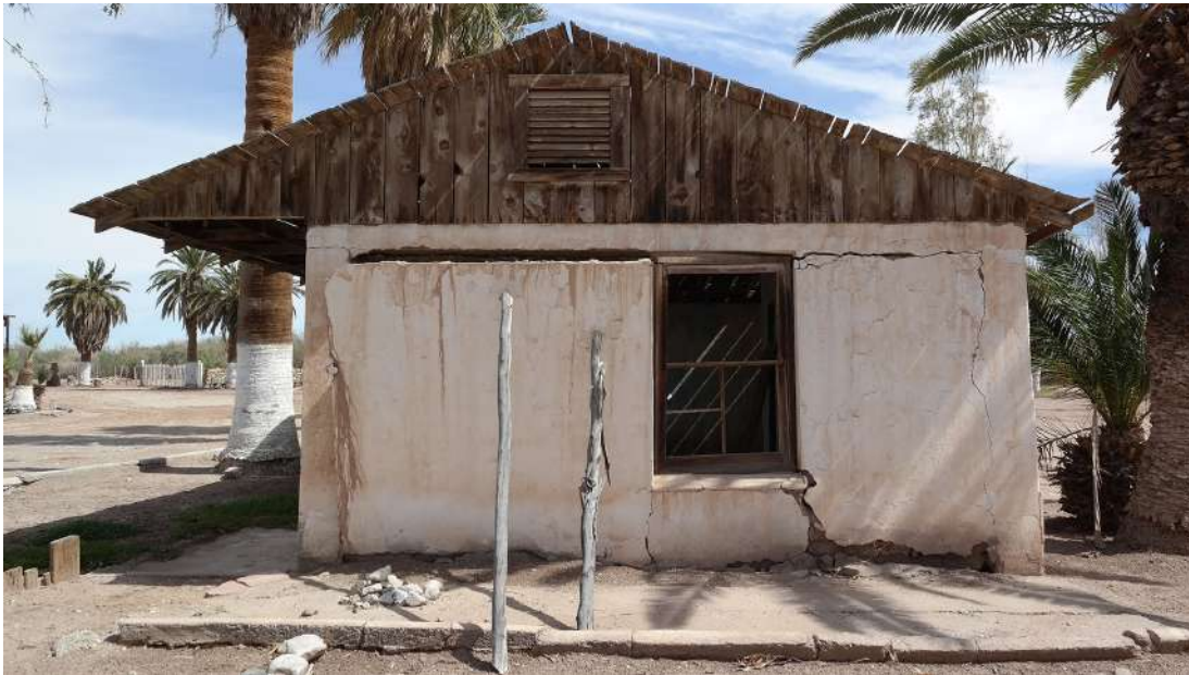
FIGURA 18. DAÑOS PROVOCADOS POR EL SISMO DE 2010. MURO DE LA FACHADA PONIENTE DEL DEPARTAMENTO DE INVITADOS DEL RANCHO DUARTE.
