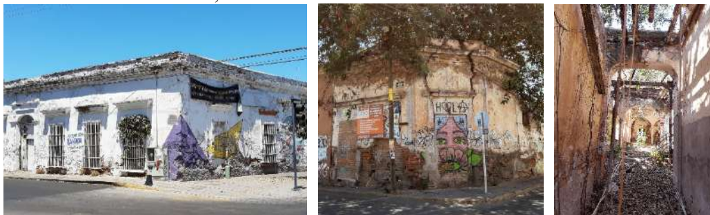
FIGURA 13. EJEMPLOS DE LAS CONDICIONES DEL PATRIMONIO ARQUITECTÓNICO POR ABANDONO, EN EL CENTRO HISTÓRICO DE CULIACÁN
