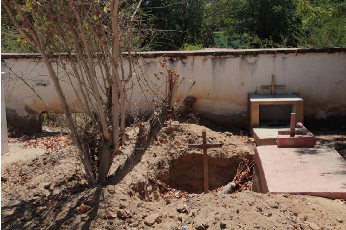
Figura 8. Cenotafios a desnivel en el Cementerio El Rastro. Colonia El Rastro. Fuente: Capturado por Orlando Godoy, 2019.
