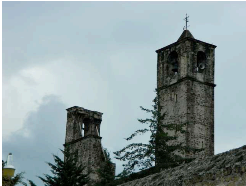
Imagen 10: VISTA DE LA TORRE DAÑADA DEL EX CONVENTO FRANCISCANO DE SAN JUAN BAUTISTA. Foto: Dejanira Ch.
